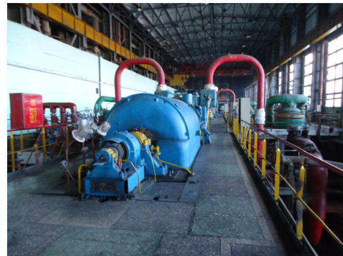
CHP3のタービン
